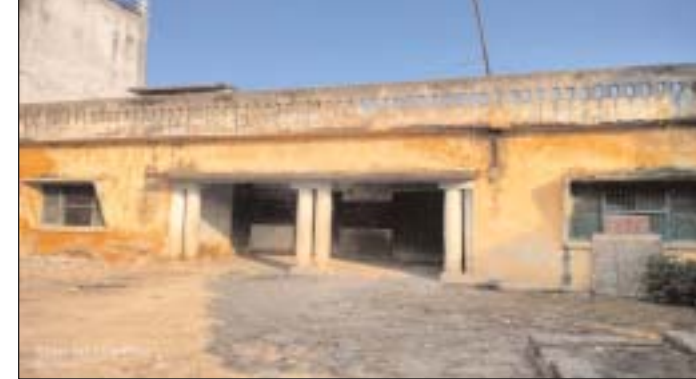
जर्जर हालत में साधन सहकारी समिति ककरहवा
